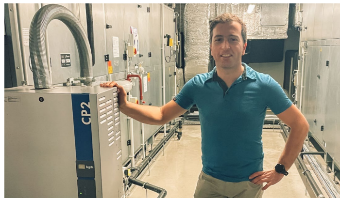
FOTO Johannes Wiesinger vor der installierten Feuchte-Rückgewinnungsanlage im PowerTower.
